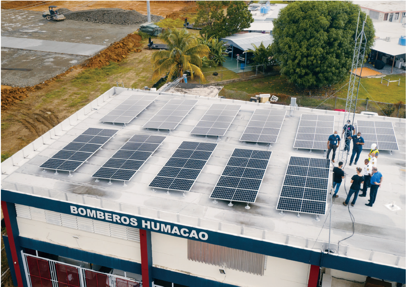
Estación de bomberos en Humacao, Puerto Rico, con un sistema fotovoltaica de 20.52 kW y un Tesla Powerwall (54 kW).
