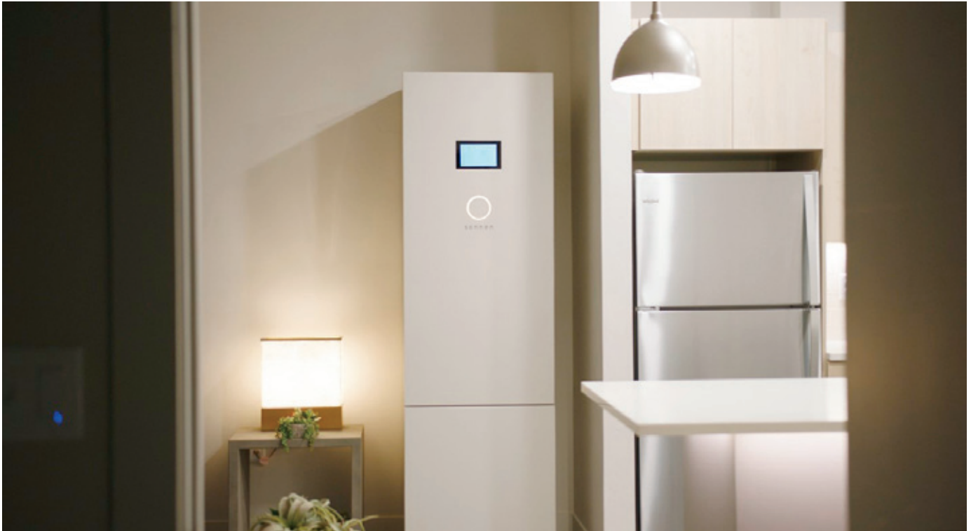
Sistema de almacenamiento de batería Sonnen en un apartamento en Soleil Lofts en Utah.
