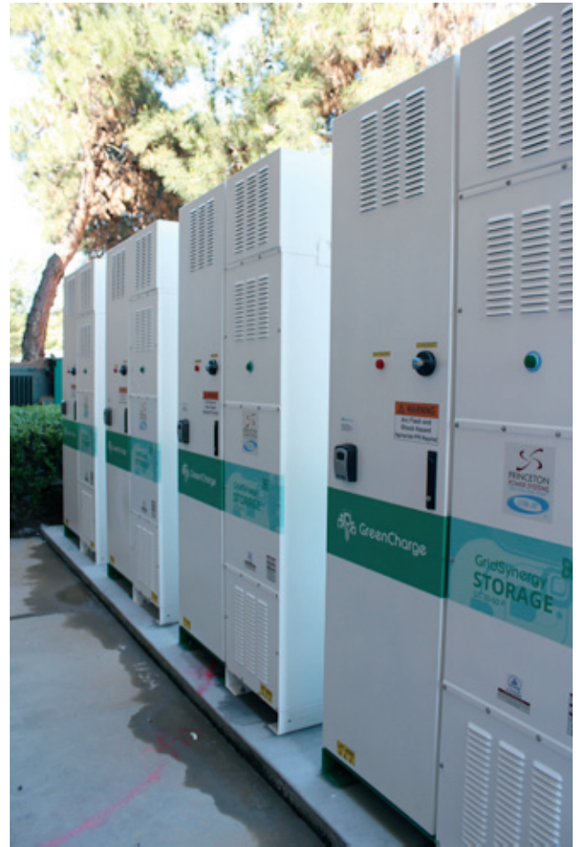
Los sistemas de baterías en el rango de 100 a 500 kilovatios-hora, como este sistema en un supermercado Safeway en San José, CA, generalmente cuestan menos que los sistemas más pequeños, alrededor del rango de $600 a $800 por kilovatio-hora.
