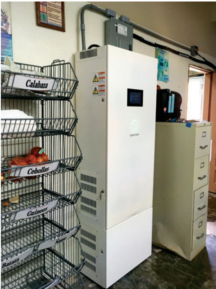
Los sistemas de baterías residenciales y comerciales pequeños, como este eco 14 sonnen de batería de 14 kilovatios-hora en una escuela remota en Orcovis, Puerto Rico, tiende a tener un costo promedio de instalación de entre $800 y $1,000 por kilovatio-hora.
