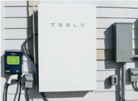
Sistema de batería residencial Tesla.
